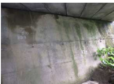
24.天王下橋: プレテン床版橋 橋長:7.80m、1983竣工。2級村道。 橋台前面の鉛直及び水平方向ひびわれ。
