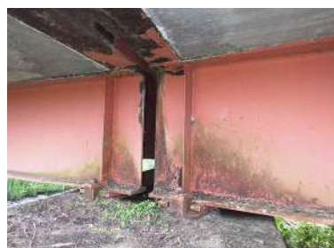
62.当地内橋: 鋼H桁橋(2径間) 橋長:34.53m、1975年竣工。1級村道。 主桁端部の塗膜劣化、錆発生。
