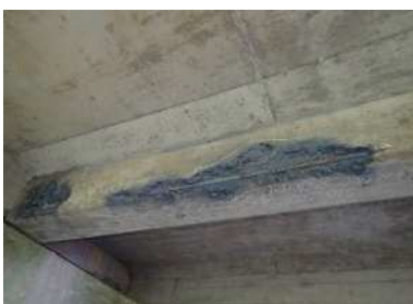
46.横堀橋: RCT桁橋 橋長:7.70m、1980年竣工。 主桁下面の鉄筋露出及びうき。
