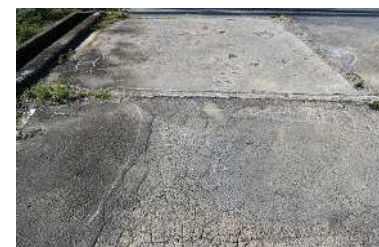
舗装の剥離、欠損、ひびわれ
