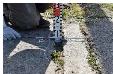
A2橋台背面の路面段差
