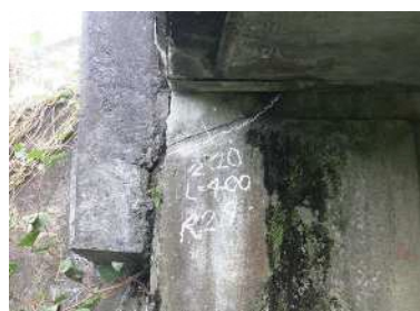
64.三ツ森橋: 鋼H桁橋 橋長:22.00m、1969年竣工。 橋台パラペットの親柱基部のひびわれ。
