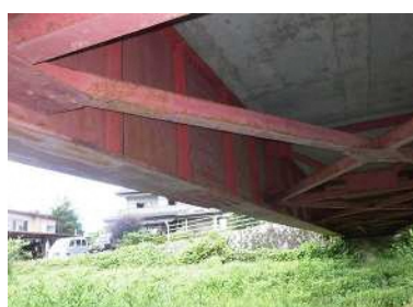
61.根崎橋: 鋼I桁橋 橋長:26.57m、1972年竣工。 主桁下フランジ部の塗膜劣化、錆発生。
