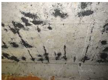
23.上宇津野橋: ボックスカルバート橋 橋長:2.20m、1980年竣工、1級村道。 ボックスカルバート頂版下面の鉄筋露出。
