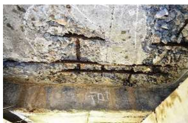
床版下面の鉄筋露出
