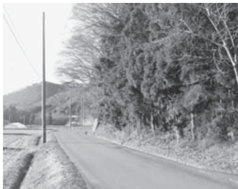
車両通行の妨げとなる支障木
