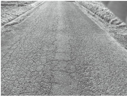
ひび割れが進む道路
