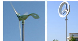
⑤小型風力発電設備
