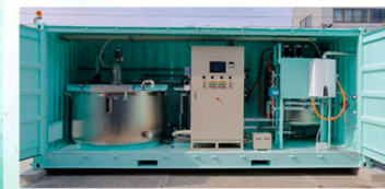
⑥バイオマス発電設備
