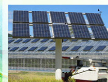
④太陽光発電設備
