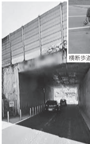
カルバート内の危険な歩道
