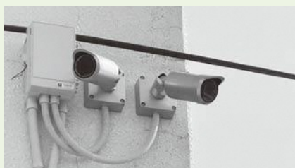
公共施設に設置されている防犯カメラ
