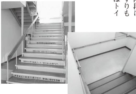
階段踊り場に設置された手すり
