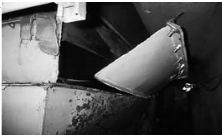
爆風による施設の破損
