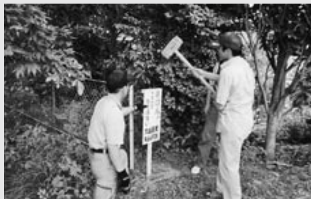
～危険と思われる箇所へ看板を設置～
