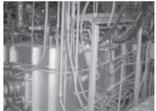
▲本宮クリーンセンター灰溶融炉
