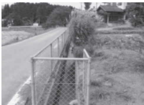
▲早急な安全対策工事を
