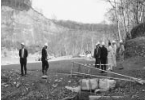
▲崩壊した山腹
