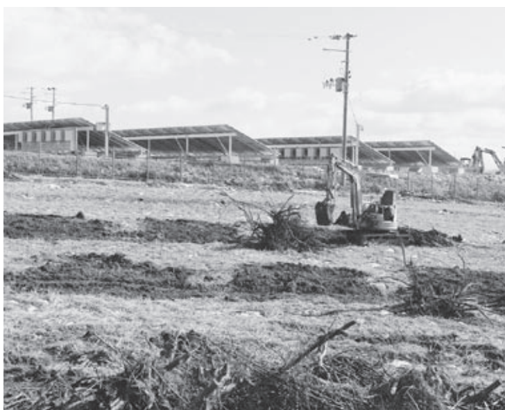
増設される太陽光発電（玉井字築館地内）
