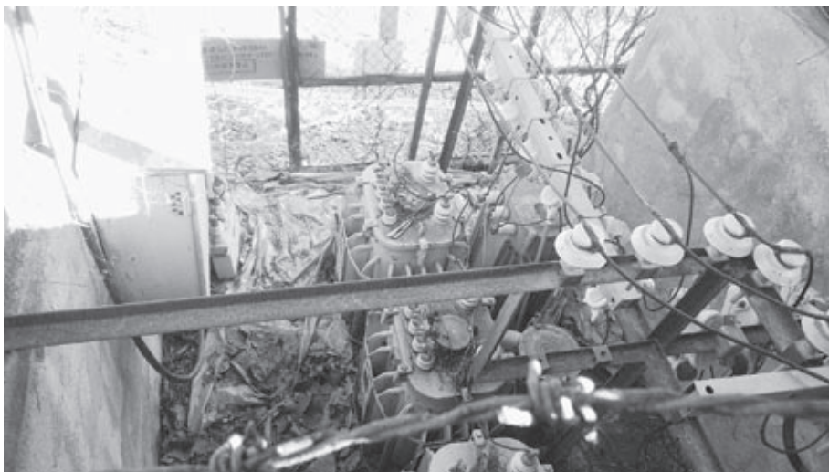
早急な撤去が求められる変圧器など
